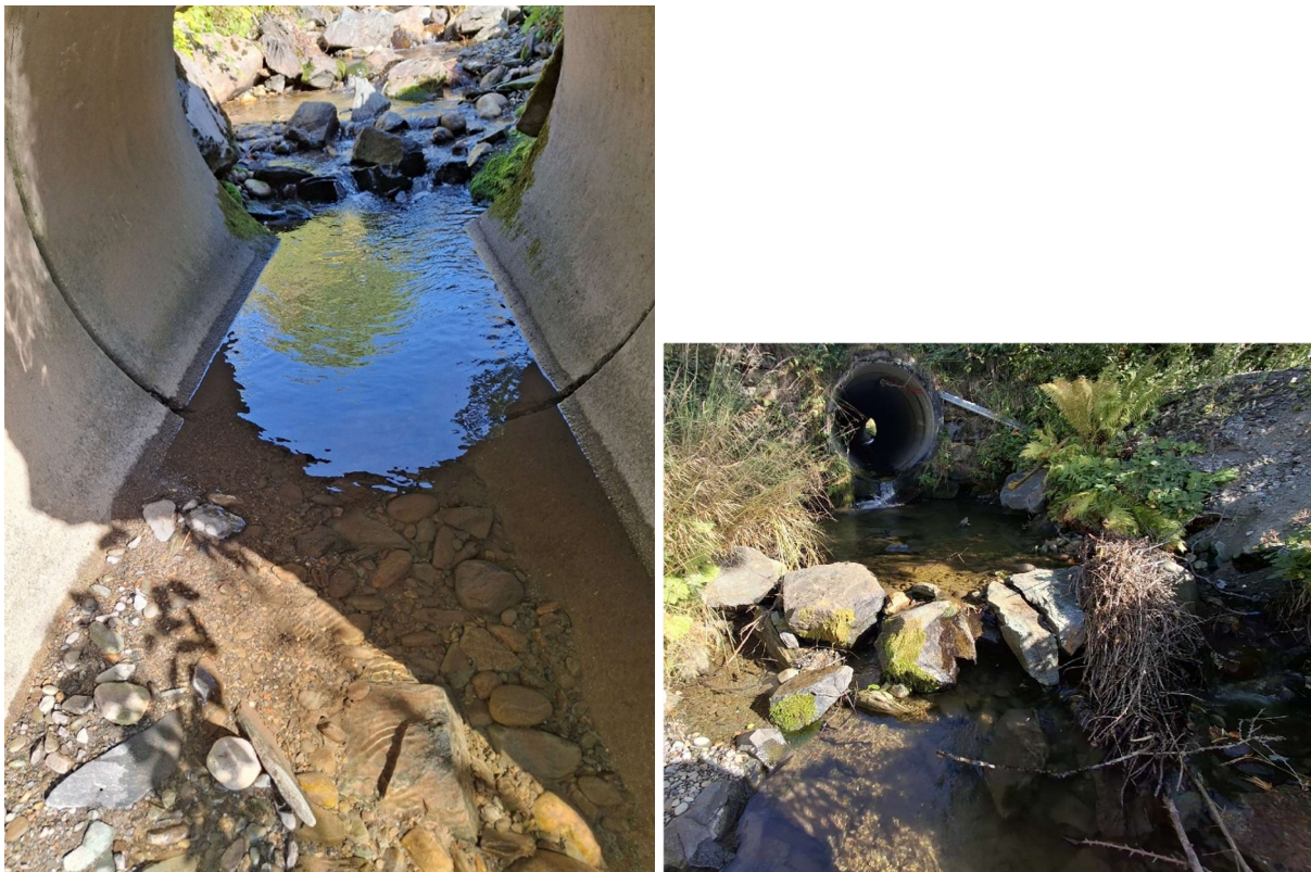
Figur 14. Bildet til venstre viser stikkrenne under stikryssing i Nygårdsbekken. Bildet til høyre viser utløp kulvert under E14 og nedenforliggende terskel. Til høyre i dette bildet skimtes løpet som bekken har gravd forbi terskelen.
