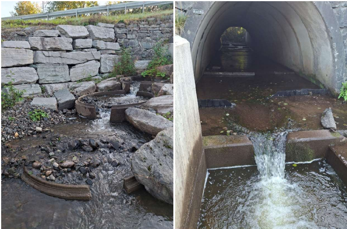
Figur 2. Bildet til venstre viser nedre del av fisketrappa i Kvernbekken. Bildet til høyre viser øverste kum i fisketrappa og Kvernbekken i kulvert under E14.
