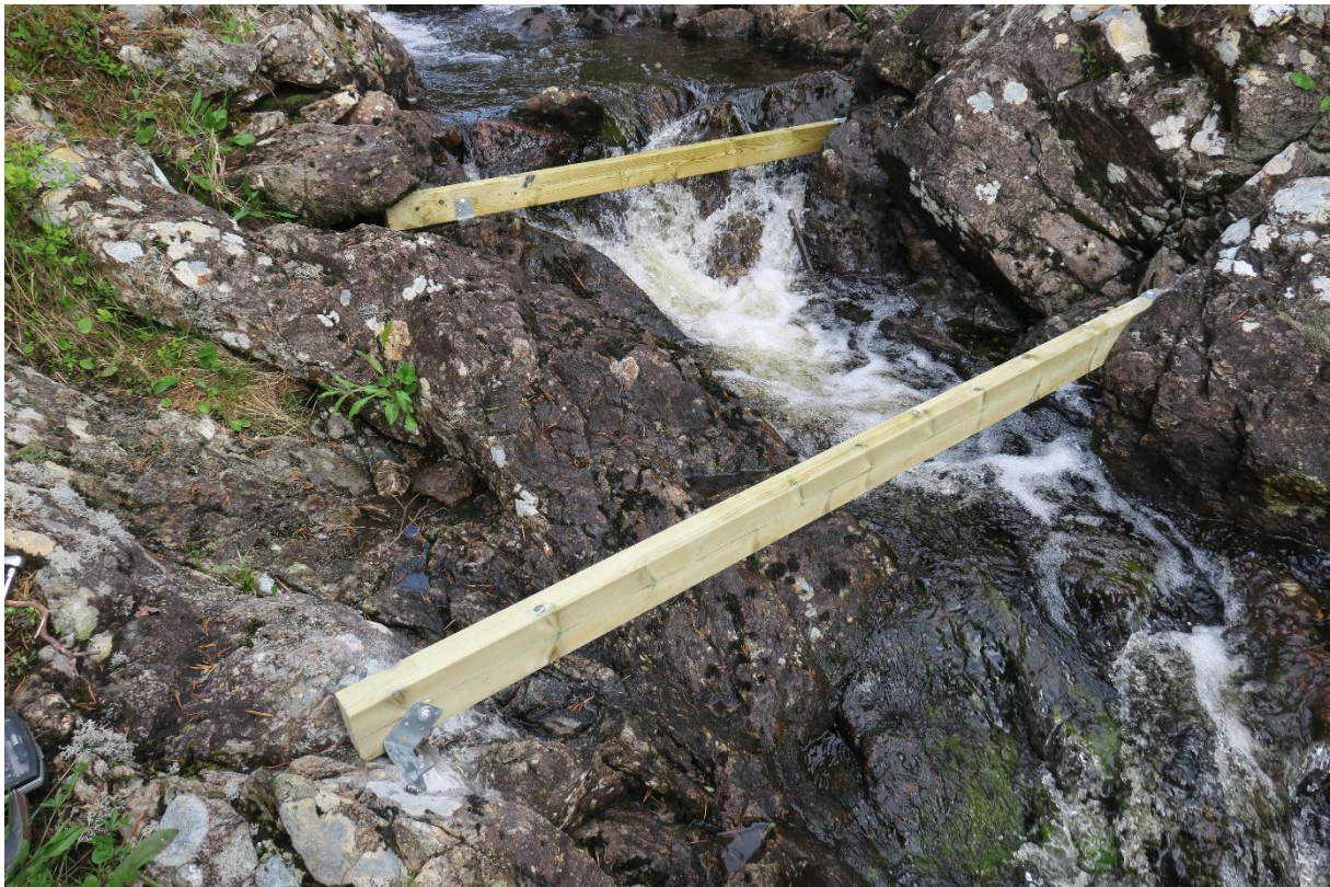
Figur 3. De naturlige formasjonene i fjellet ble benyttet for å få en best mulig forankring. Selve oppgangssperra ble montert oppå disse dragerne.
