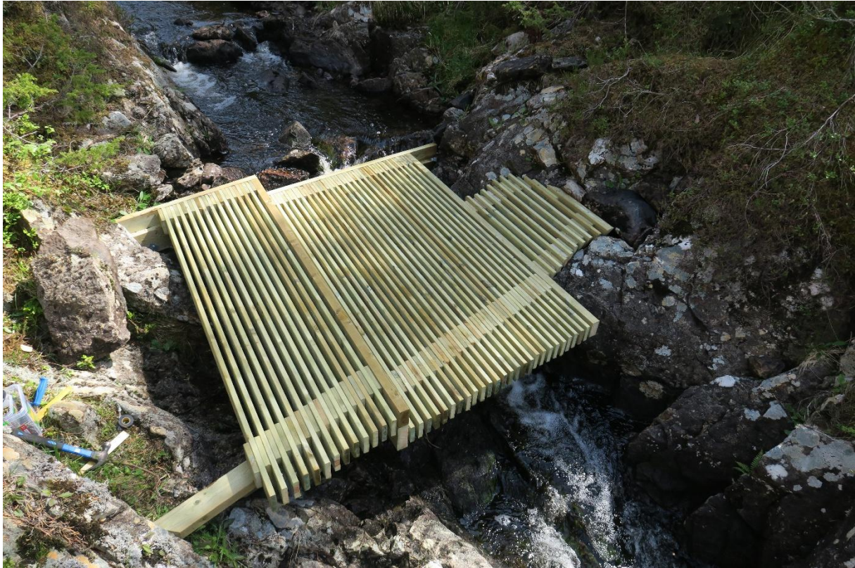
Figur 5. Oppgangsperra ble tilpasset formasjonene i berget. Det ble derfor to nivåer på bunnen, med en samlet bredde på 183 cm. samt skråmonterte spalter i ei bergskorte på den ene siden.
