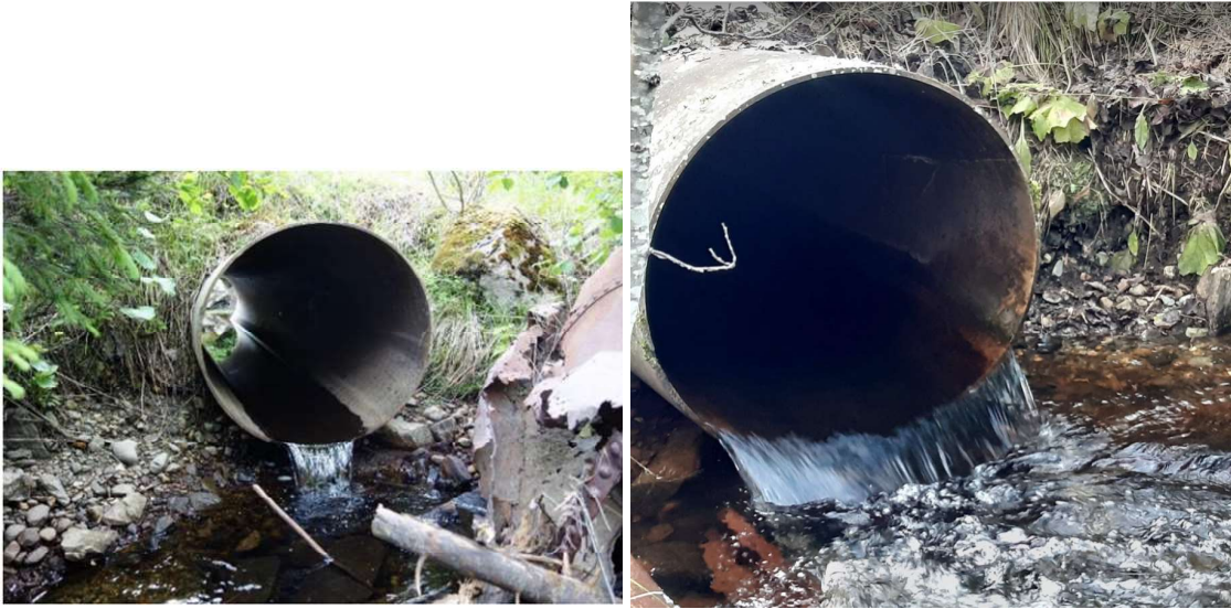
Figur 11. Bildet til venstre viser lav vannstand i kulvert under traktorvei i 2016. Foto: Thomas Ruud. Bildet til høyre viser vannstand i den samme kulverten under undersøkelsene i 2020.
